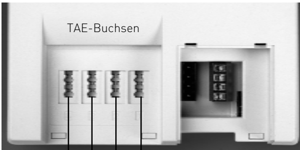
TK-Anlage mit geöffnetem Anschlussfeld
